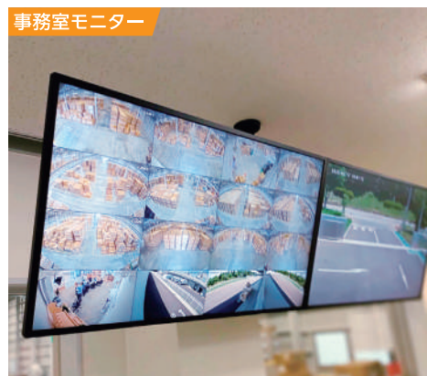
事務室内のモニターで安全を確認
